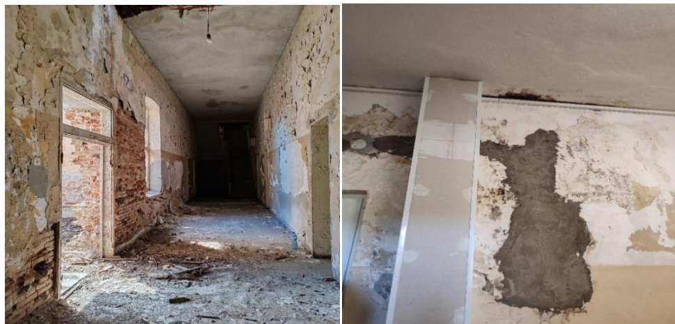
Необходимост от ремонтни дейности в ДПБ - Севлиево
